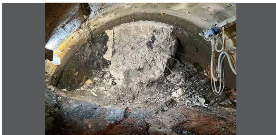
Fig. 12: Izkopno čelo kalote po dinamičnem zrušku, ki ga je spremljalo intenzivno sproščanje nakopičenih hribinskih napetosti v obliki tresenja širšega hribinskega območja, vključno s predorsko cevjo. Excavation face of the top heading after a dynamic collapse, accompanied by an intense release of accumulated rock stresses in the form of shaking of the wider rock mass area, including the tunnel tube.
