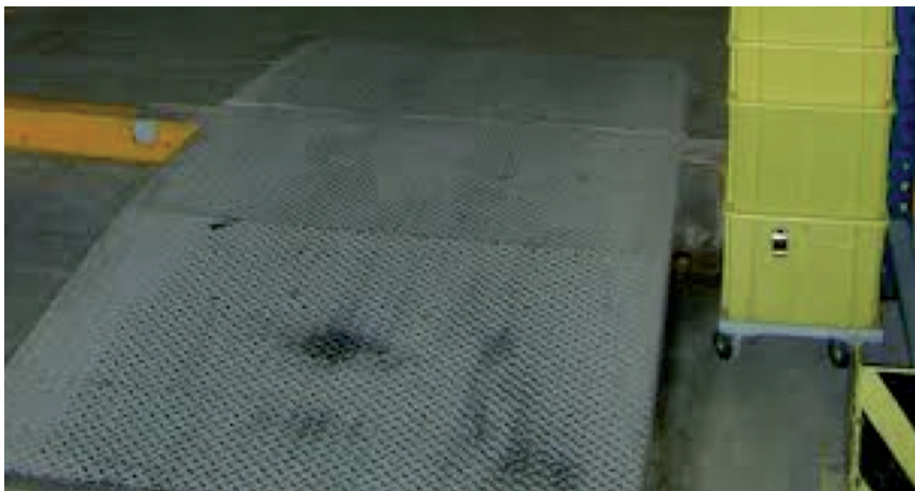
Slika 4: S primernimi prehodi se lahko ob fiksno vgrajeni opremi za zajem požarne vode zagotovi nemoteno delo v obratu (vir: www.docplayer.org )
