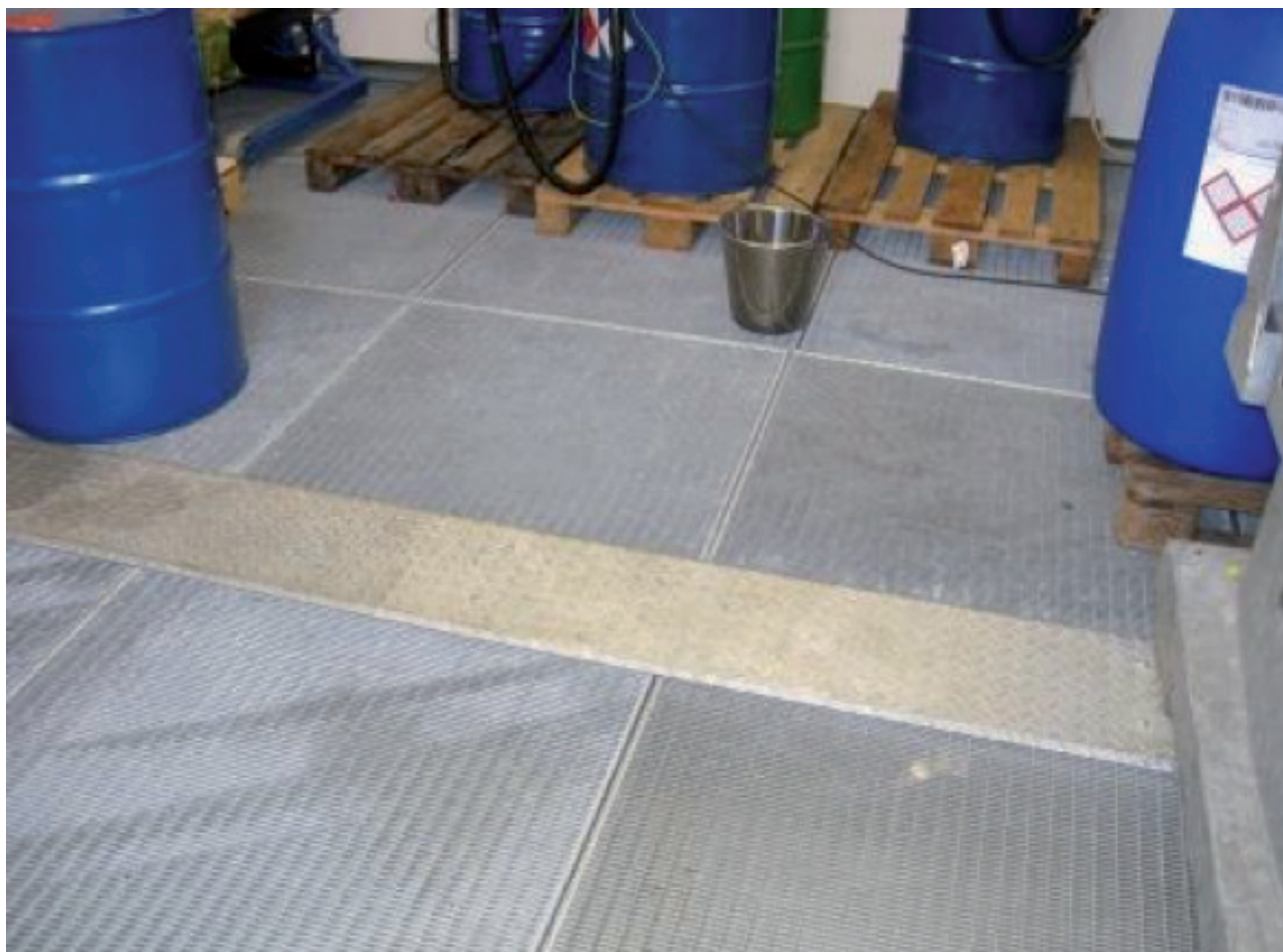
Slika 2: Zaradi lovilne posode z mrežno rešetko se lahko požarna voda zajame v samem skladiščnem prostoru (vir: www.protecto.de )
