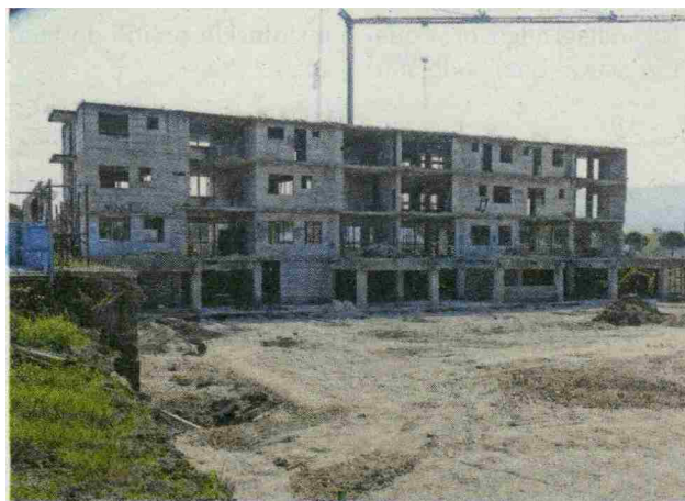
Delo na gradbišču bodoče soseske Ewol Residence kljub izrednim razmeram ni zastalo.
